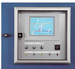
Windows®CE 10" Web-Panel: Die Visualisierung ist in den PCD Web-Servern hinterlegt
