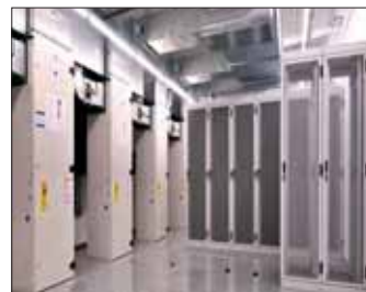
◀ Espace serveur du centre de calcul Wusys Plus de 500 compteurs d'énergie et automates sans système de supervision
