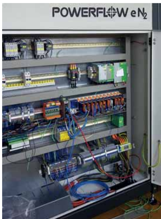
◀ Prototype Powerflow eN 2 , Power Saia® PCD3.M5567
