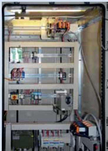
Armoire de commande après la transformation
