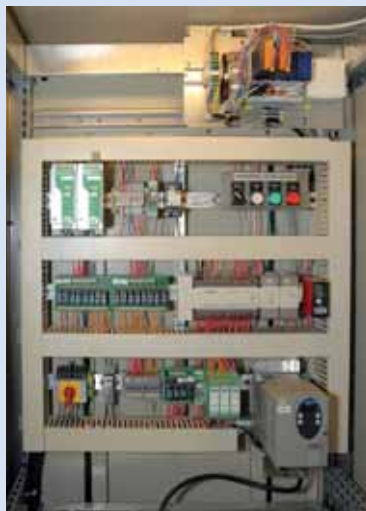
Armoire de commande avant la transformation
